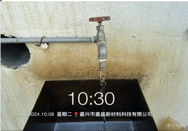
Photo of effluent
