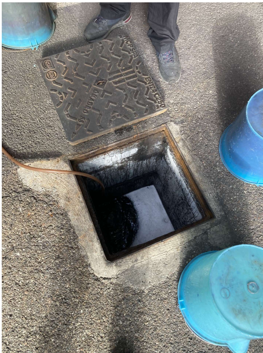
Pozzetto di campionamento
